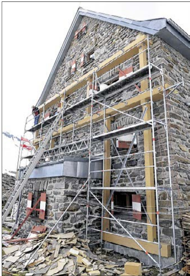
EINSTURZGEFAHR: Ein eilig angelegtes Stützkorsett rettet das Haus nur noch maximal fünf Jahre.
