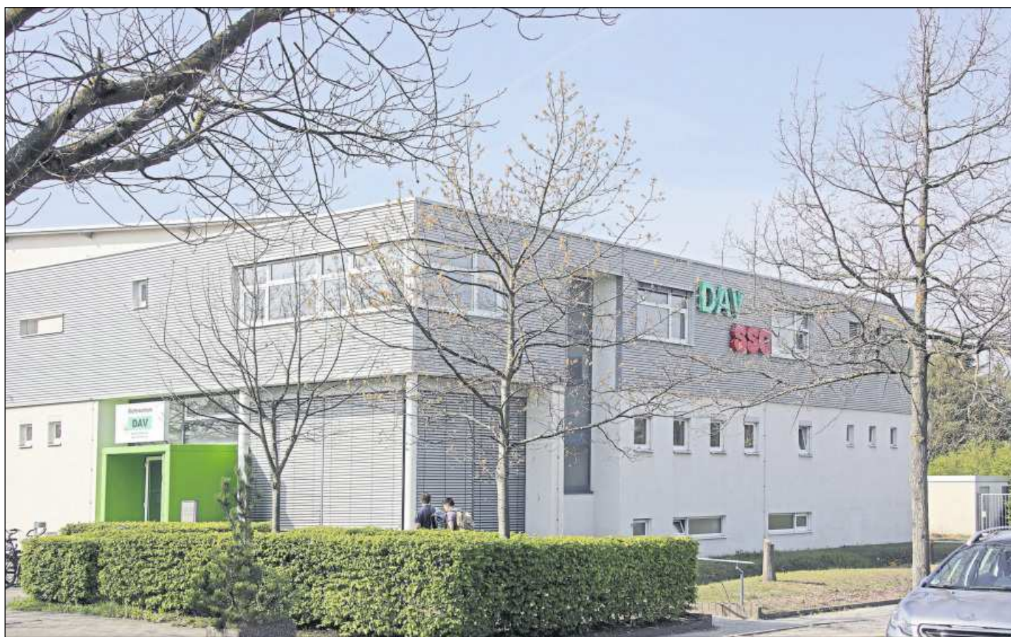
DIE KLETTERHALLE des Alpenvereins Karlsruhe beim Fächerbad in der Waldstadt platzt aus den Nähten. Der Erweiterungsbau für rund 900 000 Euro soll bis Jahresende stehen und im April 2018 vollständig ausgebaut sein. Foto: jodo
